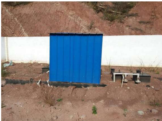
五凤收费站一体化污水处理装置
