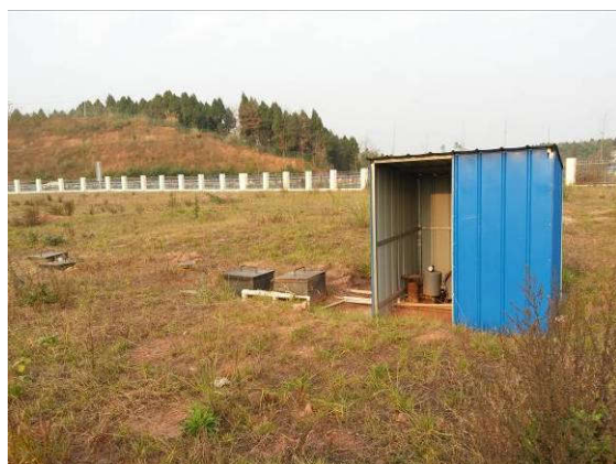
管理中心一体化污水处理装置
