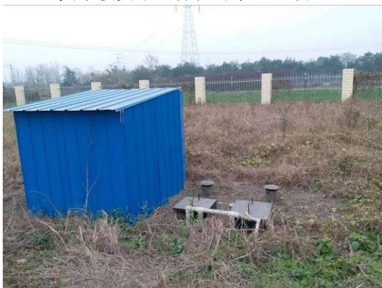
金堂收费站一体化污水处理装置
