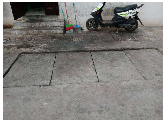
人和收费站食堂隔油池
