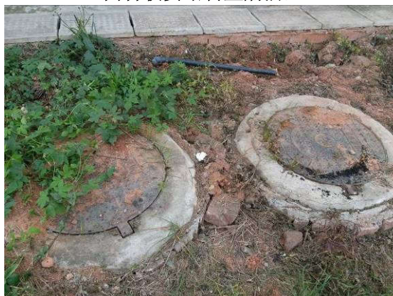
贾家收费站食堂隔油池
