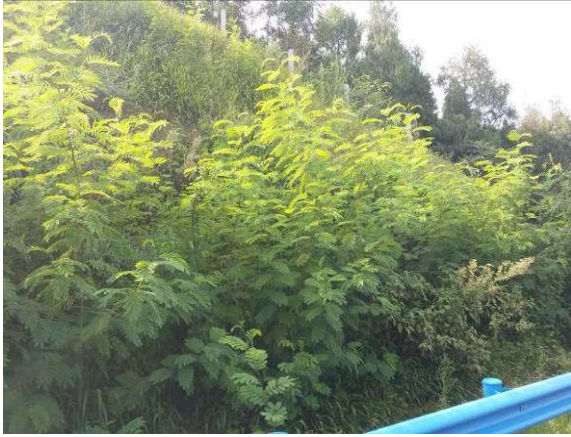
上边坡植被防护
