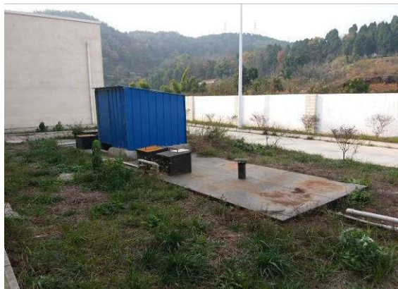
三岔湖服务区一体化污水处理装置
