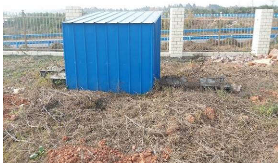
贾家收费站一体化污水处理装置
