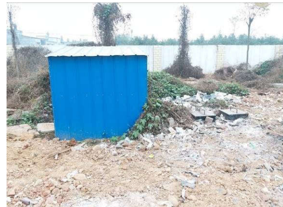
广汉停车区一体化污水处理装置
