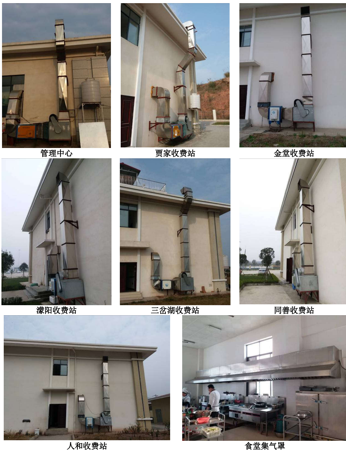
图 8-1 沿线服务设施食堂油烟净化器安装情况
