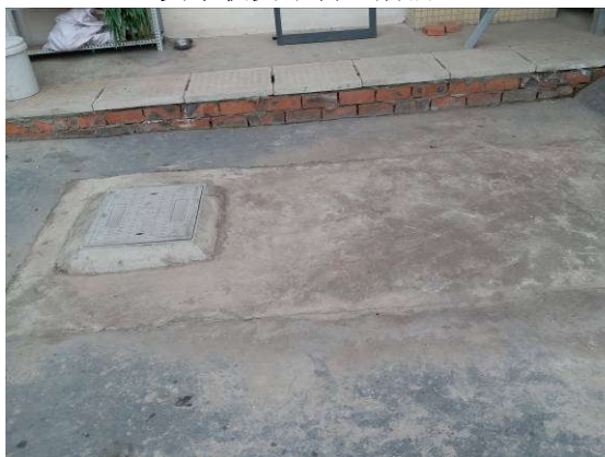
金堂收费站食堂隔油池
