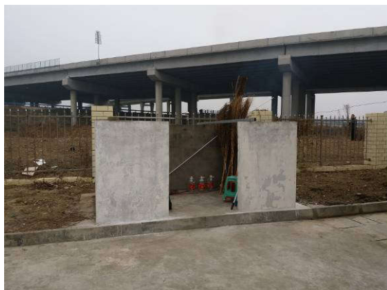
同善收费站 垃圾池
