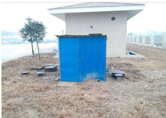
濛阳收费站一体化污水处理装置
