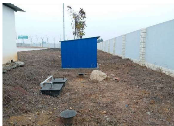
青白江服务区一体化污水处理装置
