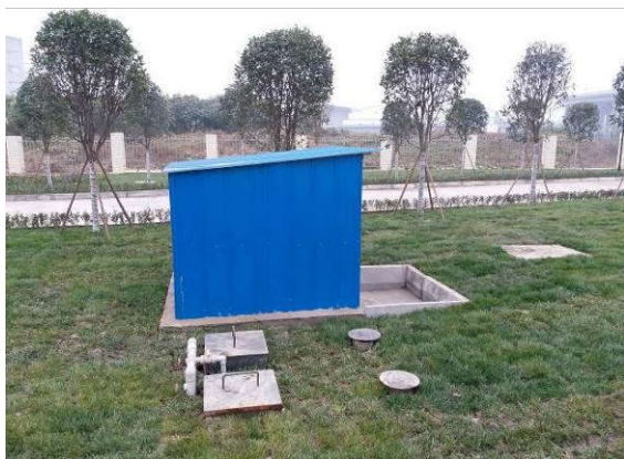
同善收费站一体化污水处理装置
